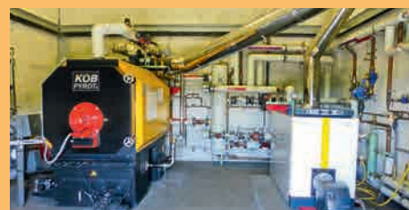
Chaufferie EHPAD La Bastide de Serou
